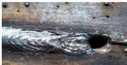
2-rasm. Aravacha ramasidagi birikmalarning yoriqlari
