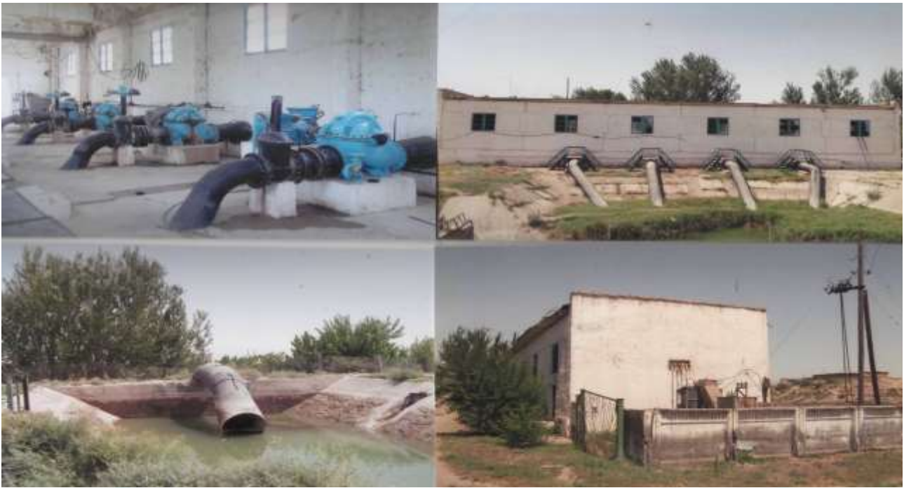
1.1-rasm. Navro'z nasos stansiyasining umumiy ko'rinishi.
